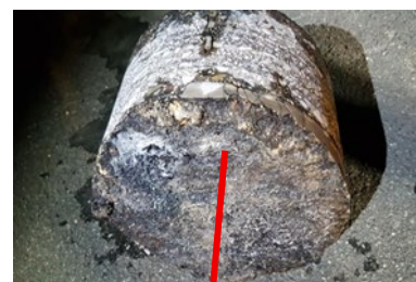
Parte del soporte arrancado por el SEIREPOX A/N
